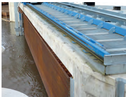
Abb. 7: Querrechen an einer Wasserkraftanlage in Öblitz bei Naumburg an der Saale in Sachsen-Anhalt. Foto: Olaf Lindner
